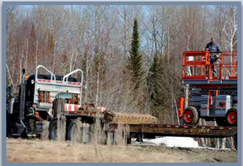
Photo 2. La plateforme a été reconstruite et installée à l'aide d'une nacelle à plus de 10 mètres
