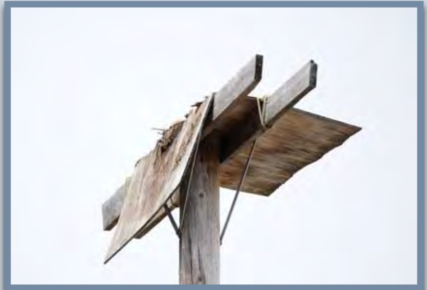
Photo 1. Plateforme brisée et inutilisable
